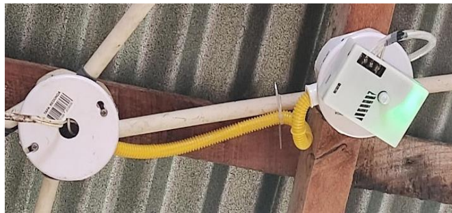
Figura 8. Prototipo instalado en el tumbado de una vivienda
